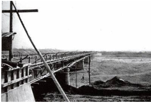
松川橋の建設 写真は昭和 35 年 昭和 36 年に完成した現在の鉄筋コンクリート製の橋(松川橋)を架ける工事中
