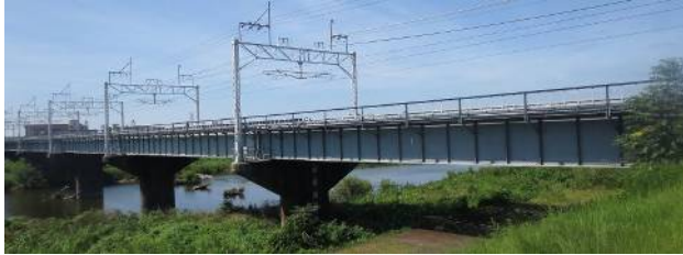
勝川橋上流約 530m 程にある中央線庄内川橋梁 (右岸上流から) (令和 2 年)
